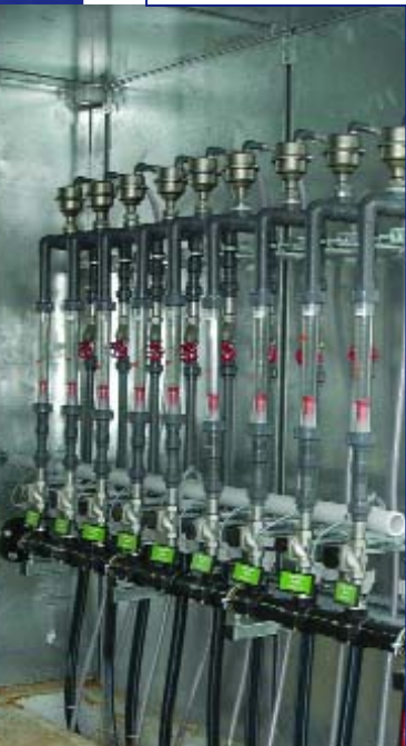
Re-Infiltrationssystem einer unterirdischen Enteisung
