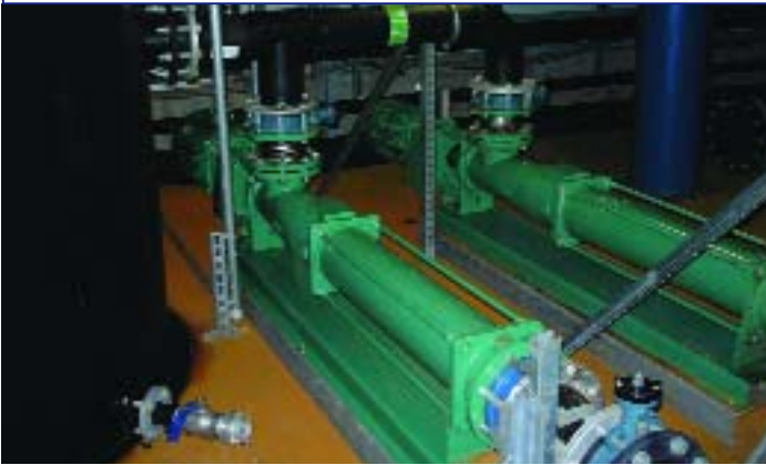
Exzentrerschneckenpumpen innerhalb einer Schlammkonditionierung
