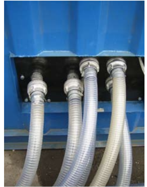
Zulaufleitungen von den Schlürfbunnen in den Container
