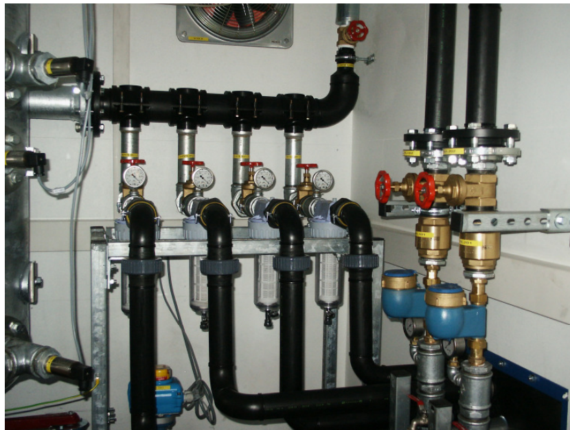
Abb. 3: Sammelbalken für die Zusammenführung der Schlürfleitungen
