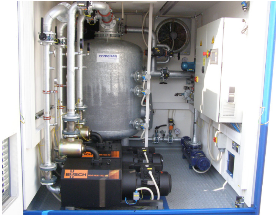
Abb. 4: Schlürfanlage (MPE-System) eingebaut in einen 10 Fuß Container (ohne Aktivkohlefilter)
