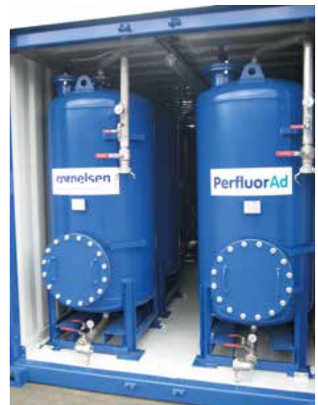
01 Kleinfilteranlage für Grundwasseraufbereitung mit Spezialadsorbens
